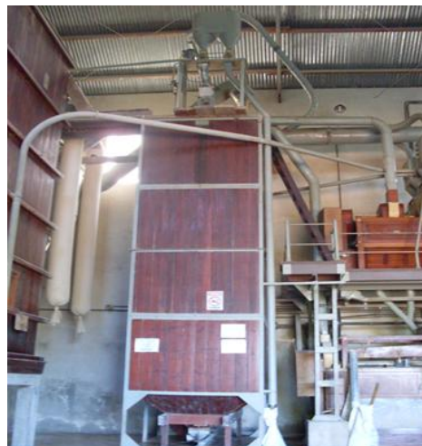
Figura 03- Caixa de umidificação com registro acoplado.
