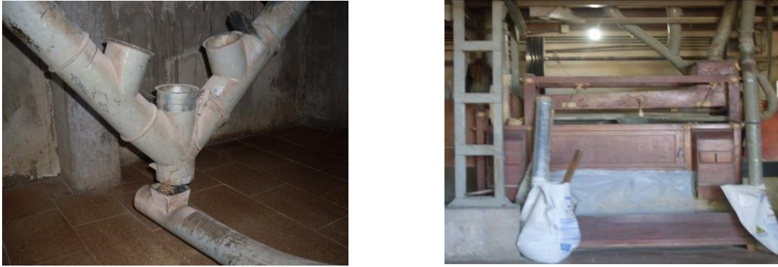
Figura 02- Registro da Caixa Depósito (esquerda) e maquina de limpeza (direita) usada na limpeza dos grãos.
